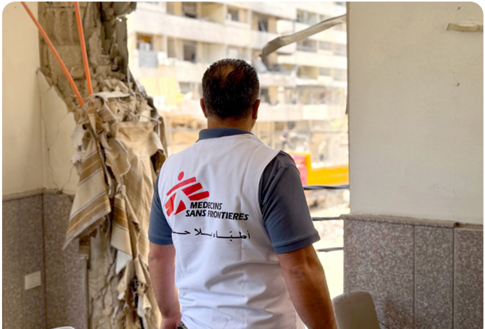
Dahieh, Beirut – Mai 2026 – Ein Mitarbeiter von Ärzten ohne Grenzen steht in einem Gesundheitszentrum, das bei einem Luftschlag beschädigt wurde. Wir bemühen uns, trotz der angespannten Lage die Grundversorgung sicherzustellen.
